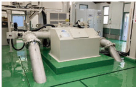
名村川発電所で導入したターゴインパルス水車
