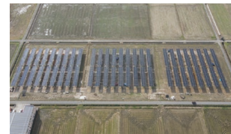
田んぼの上に設置された太陽光発電設備
