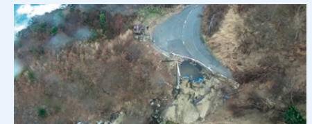
ドローンによる被害状況確認
