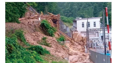
白峰発電所・変電所への土砂流入
