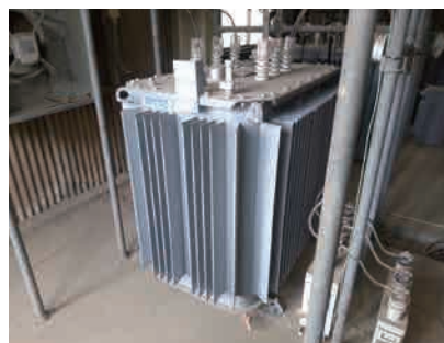
更新した変圧器
