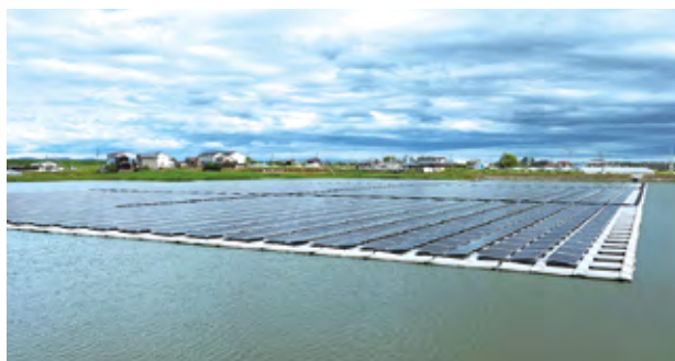
オフサイトコーポレートPPAで活用している水上太陽光発電施設
