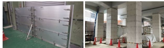
高津変電所 浸水対策（止水板設置済み） 東横線・目黒線 多摩川駅～新丸子駅間 補強後の高架橋柱
