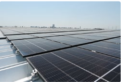
東武商事が設置した太陽光発電所
