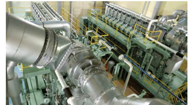
ガスエンジン発電設備
