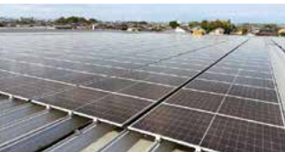
長浜CKに増設した太陽光発電設備
