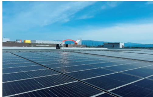
太陽光発電設備
