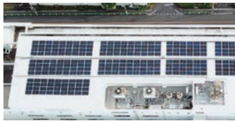
本社3号館屋上の太陽光発電設備
