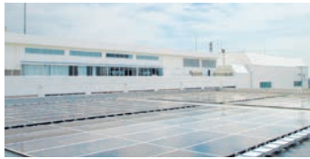
2024年7月より稼働した本社6号館屋上の太陽光発電設備
