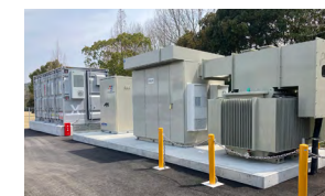
太陽光併設蓄電所 (FIP)
