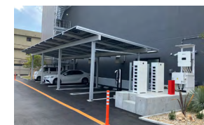
オフグリッドEVステーション
