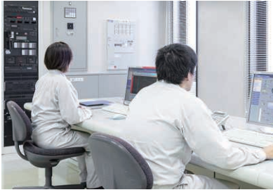
下水処理場中央監視制御室での設備運転状況の監視
