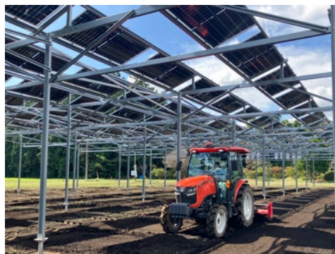
ほ場に設置された太陽光発電設備
