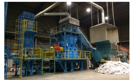
プラスチック破碎選別施設
