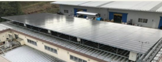
菟野町本社屋上の太陽光パネル(2007年～)
