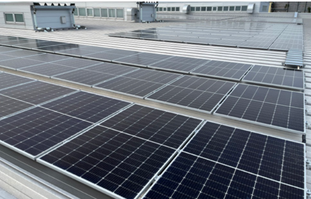
埼玉工場のソーラーパネル
