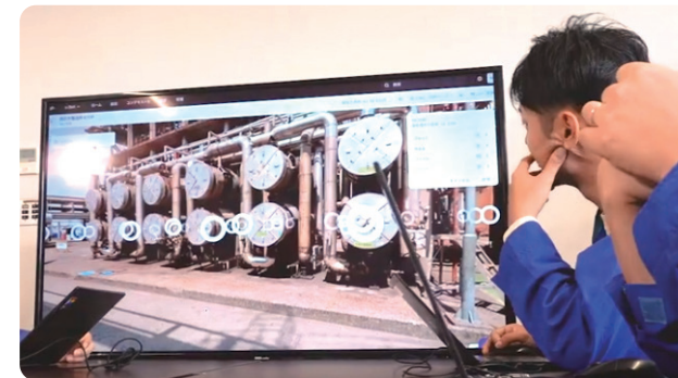
VRデータを活用して設備の状況を確認の様子
