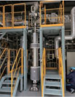
共創の舞台（横浜市）にあるベンチ設備
