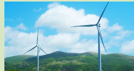
リエネ松前風力発電所
