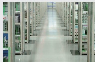
棚の下に設置した防震装置 (ミュソレーター™)
