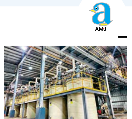
聯友金属科技(リエンヨウメタルズ)の溶媒抽出設備
