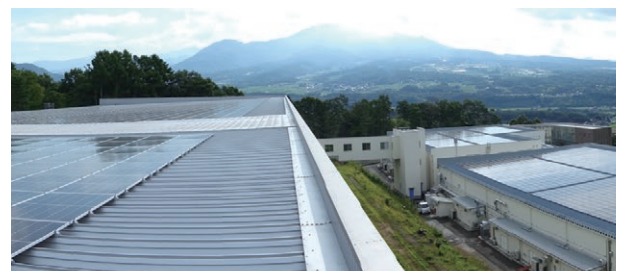
山梨工場新棟の屋上に設置された太陽光パネル
