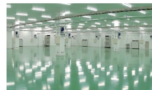
新棟のクリーンルーム
