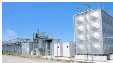
鳥取事業所のエコキュート設備
