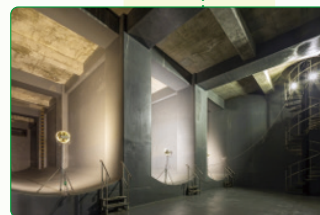
2020 渋谷駅東口地下貯留槽
