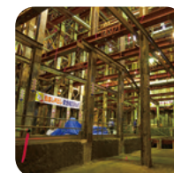
渋谷駅東口基盤整備工事 (第1工区)
